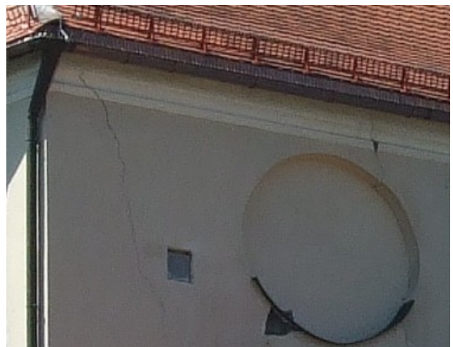
Deutliche Rissbildung am Kirchenschiff vor der Sanierung.
